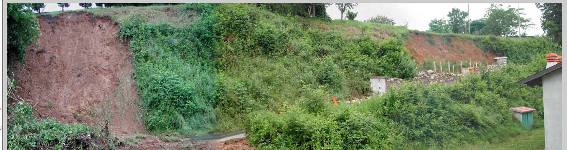
11 - Piccole franette nella strada in Fraz. Roletti, presso il bocciodromo. (evento alluvionale 2002)
